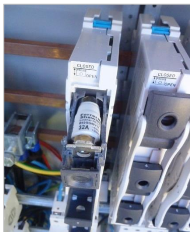
Bild 5-39: Trenner mit Sicherung
