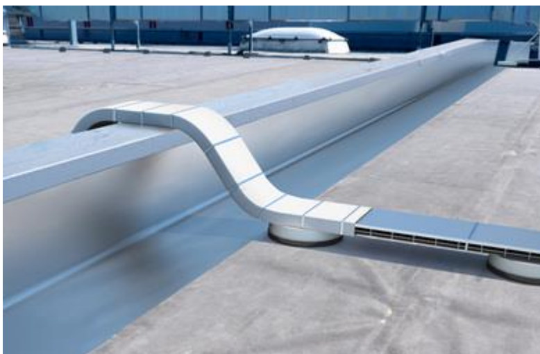
Bild 5-25: Brandschutzbandagen können die Weiterleitung über Brandmauern verhindern, Foto: Obo Bettermann, [73]
