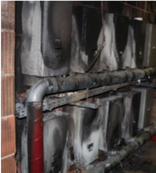
Bild 3-23: Technikraum einer PV Anlage nach einem Brand
