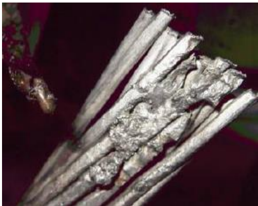
Bild 3-29: Das Ende einer Aluminiumleitung (Foto: Uli Motzer, Württembergische Versicherung)
