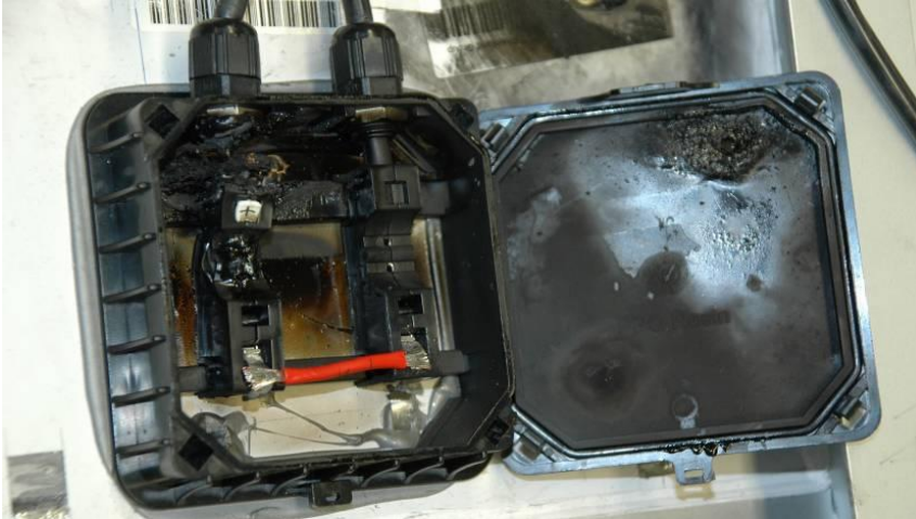
Bild 3-43: Anschlussdose nach Lichtbogen zwischen Anschlussleitung und Anschlussklemme [5]
