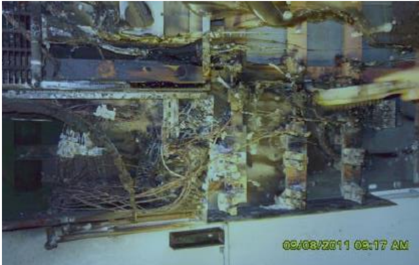
Bild 3-28: Ausgebrannter AC Anschluss einer PV Anlage (Foto: Uli Motzer, Württembergische Versicherung)
