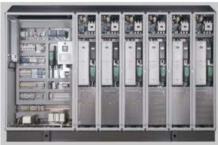
Bild 3-55: Beispiel eines Zentralwechselrichters in einem Schaltschrank
