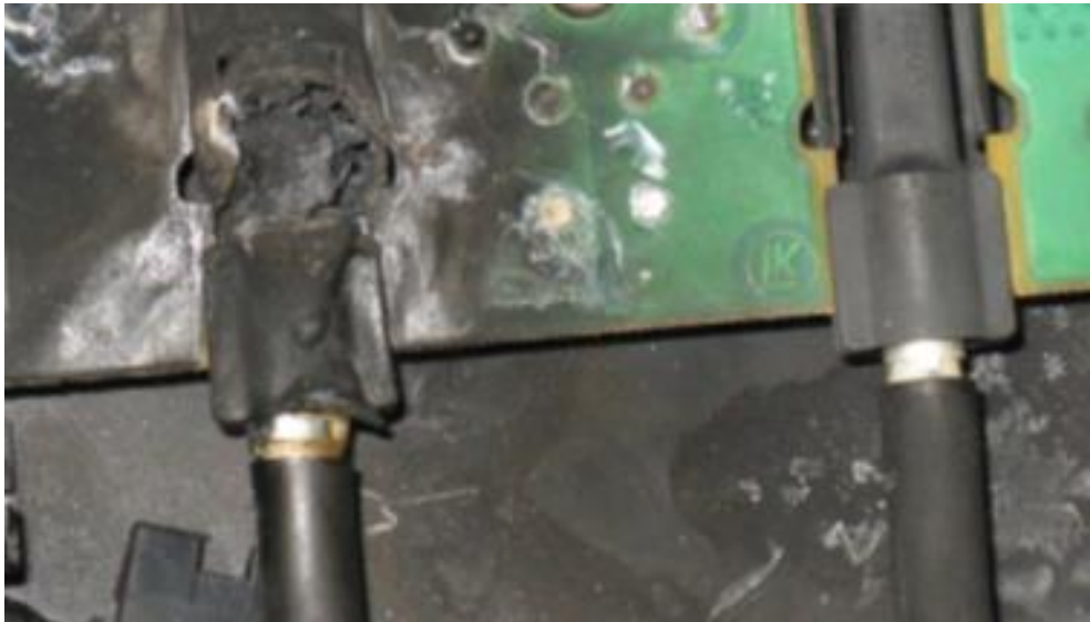
Bild 3-27: Beschädigte Steckkontakte in einer Modulanschlussdose
