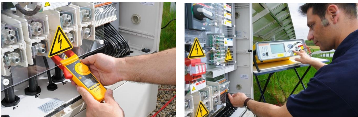
Bild 5-33: Strangmessungen am Generatoranschlusskasten
