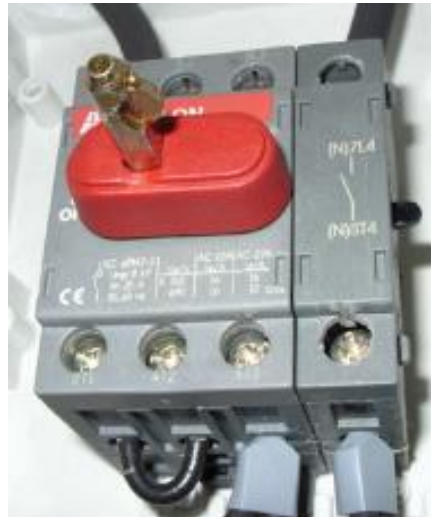
Bild 3-26: Geprüfter DC Hauptschalter mit Kontakt -Wippe
