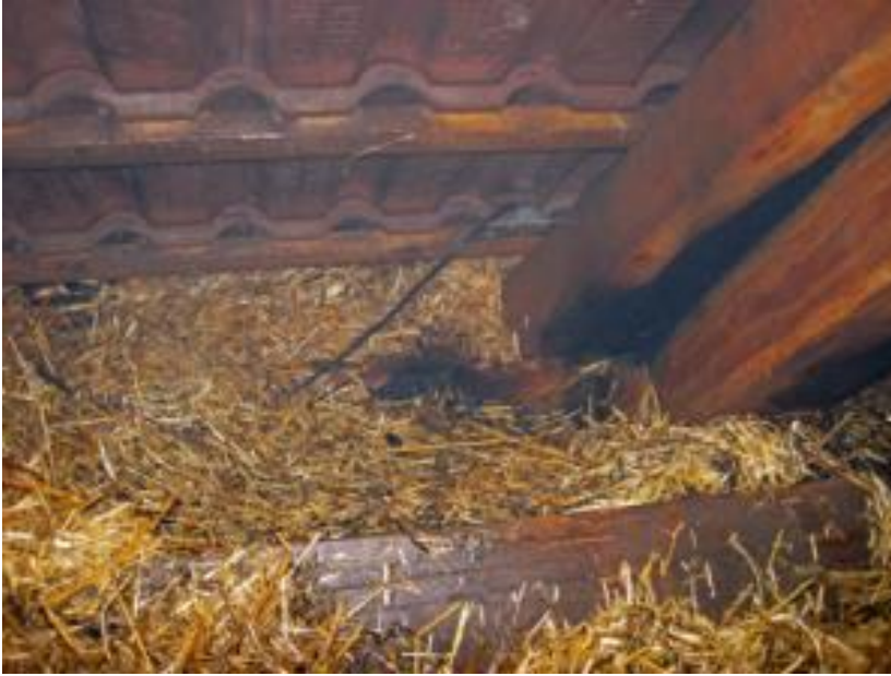
Bild 3-33: Glimpflich verlaufener Brandfall (Foto: Feuerwehr Ellwangen)
