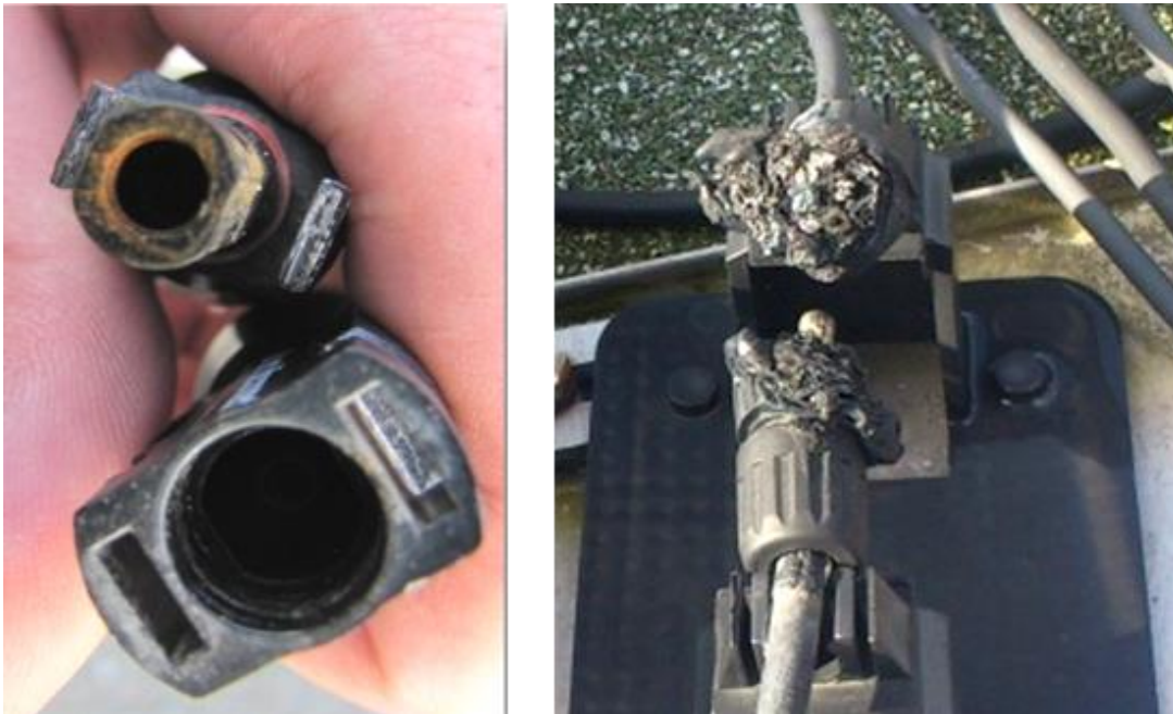
Bild 3-48: Ergebnis der Paarung von Steckverbindern unterschiedlicher Hersteller [33]
