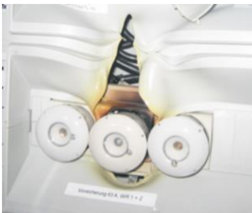
Bild 3-30: Heiß gewordener Sicherungseinsatz (Foto: H. Godard, Energossa)
