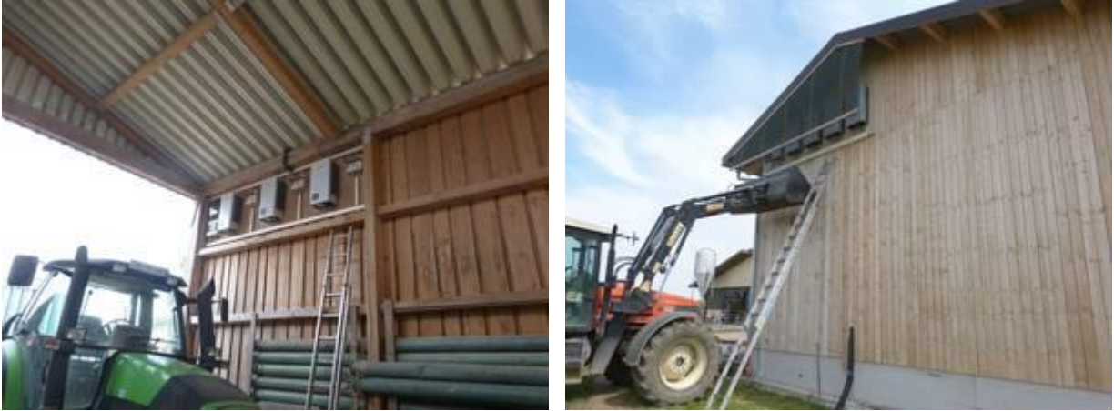
Bild 3-14: Nicht brandschutzgerechte Installation von Wechselrichtern auf Holz, zudem schwer erreichbar für die Wartung, Fotos: W. Schröder, PV-Sachverständiger, 2014
