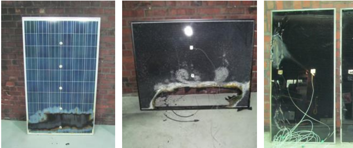
Bild 3-2: Beschädigungen nach Beanspruchung mit 25 kW Brennerleistung, links: c-Si, Mitte: CIS (quer angeordnet), Rechts: CdTe (quer angeordnet)
