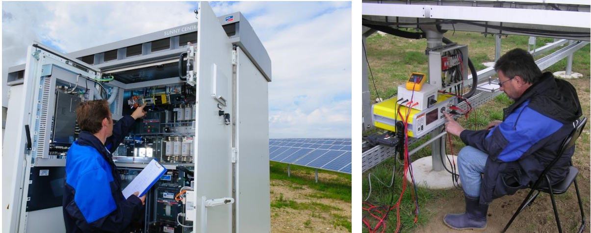
Bild 5-34: Sichtprüfung (links am WR) und Messung (rechts am GAK) im Rahmen der Abnahme
