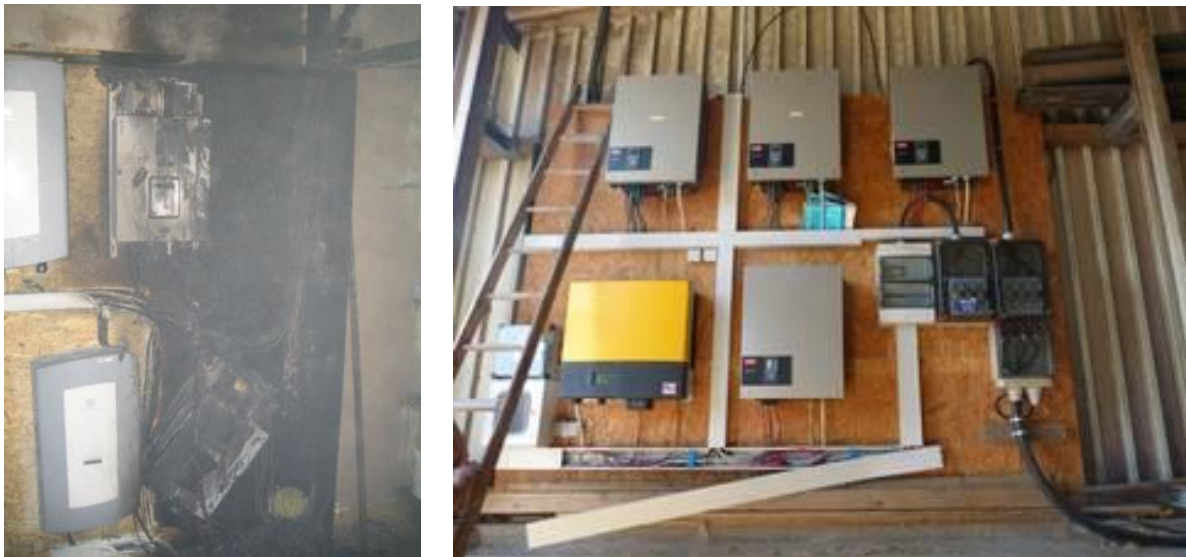
Bild 3-32: Montage der Wechselrichter auf OSB Platte, Links: hier ist es passiert, Foto: Freiwillige Feuerwehr der Gemeinde Perl, 2011, Rechts: Hier sieht es optisch gut aus, ist aber nicht brandschutzgerecht, Foto: W. Schröder, PV-Sachverständiger, 2014
