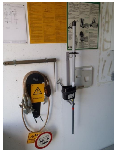
Bild 5-42: Erd- und Kurzschluss-Kit für den Transformator
