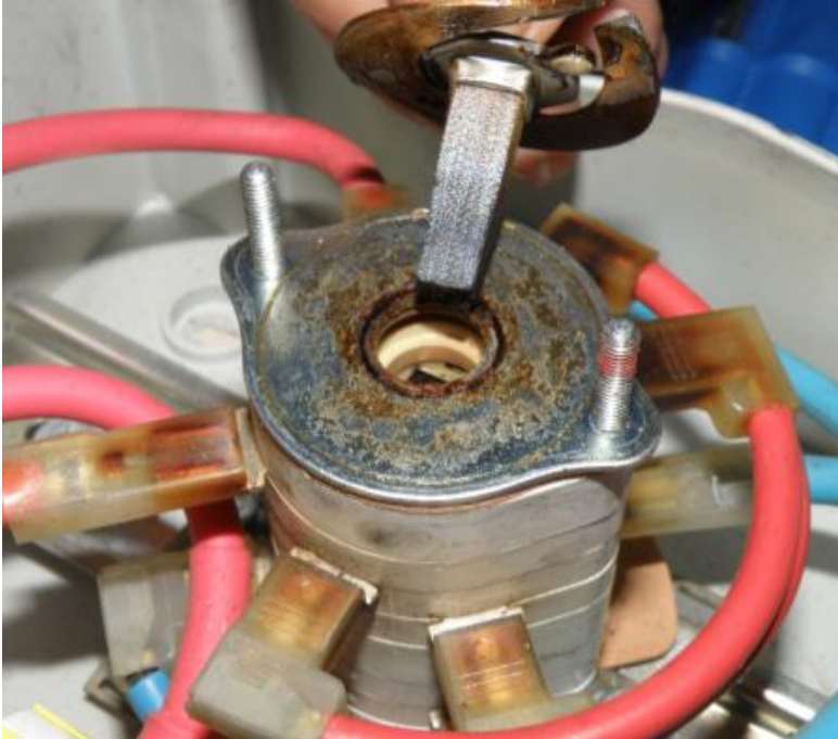
Bild 3-24: Deutliche Überhitzungsspuren an Anschlüssen und im Inneren eines „überlebenden“ Schalters
