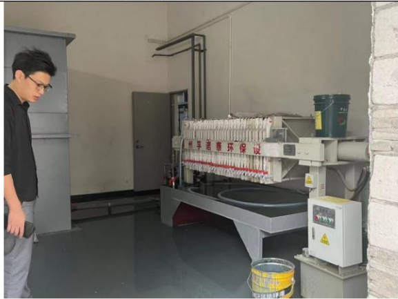
园区废水处理站
